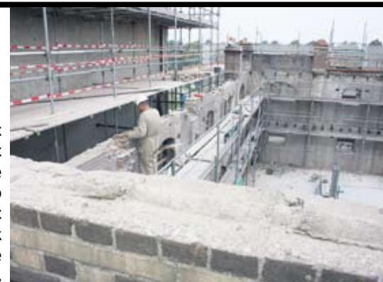
► Bij het herstel gaat het vooral om het stabiliseren van de bestaande situatie. Zo wordt bijvoorbeeld het uitgebuite metselwerk niet teruggebracht in de oorspronkelijke stand.
